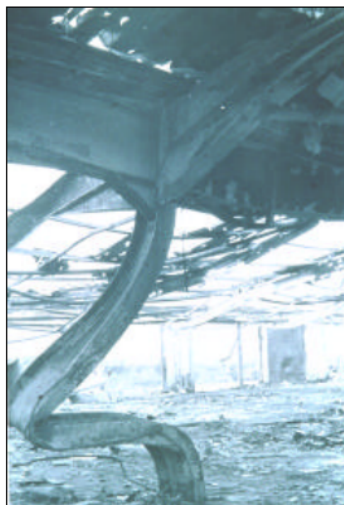
Figura 7: Colapso de coluna interna.
