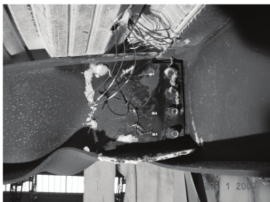
Figura 9: Deformação do feixe da placa da aleta na conexão da coluna
