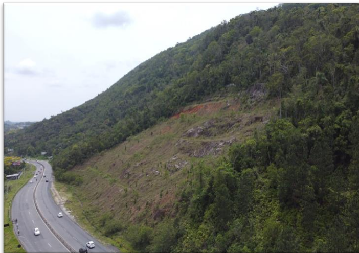
Figura 4: Vista geral do local do escorregamento.
