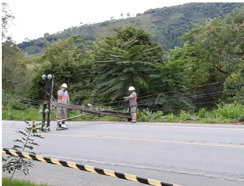
Figura 6- Poste caído na via após ter sofrido colisão de carro.
