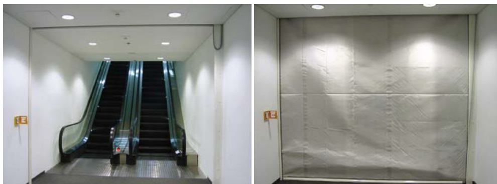
Figura 9- Cortina de proteção contra incêndio protegendo escada
