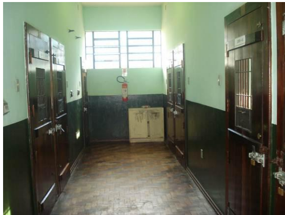
Figura 8 – Extintores alocados nos corredores dos leitos
