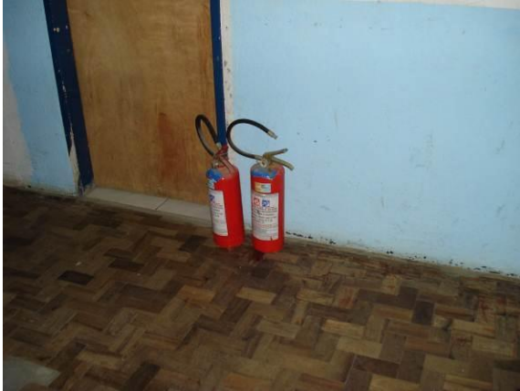
Figura 3 – Extintores PQS 4 KG na carceragem
