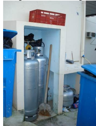
Figura 4 – Central de gás
