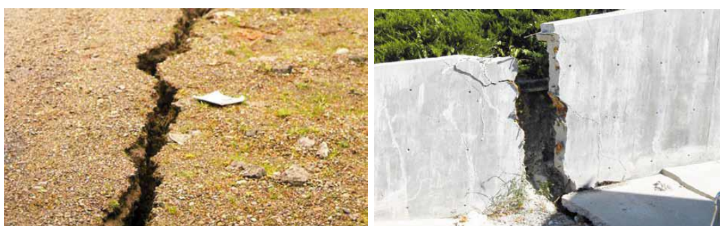
Figura 23- Rachaduras do solo e calçada afastando-se da casa.
