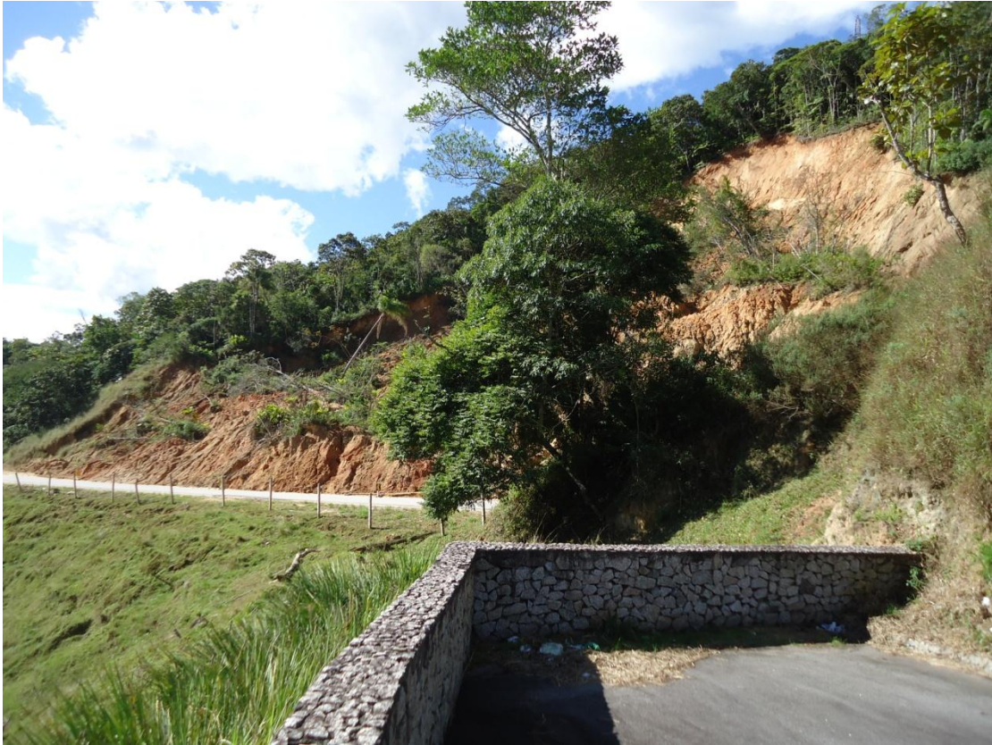
Grande deslizamento obstruindo a via.
