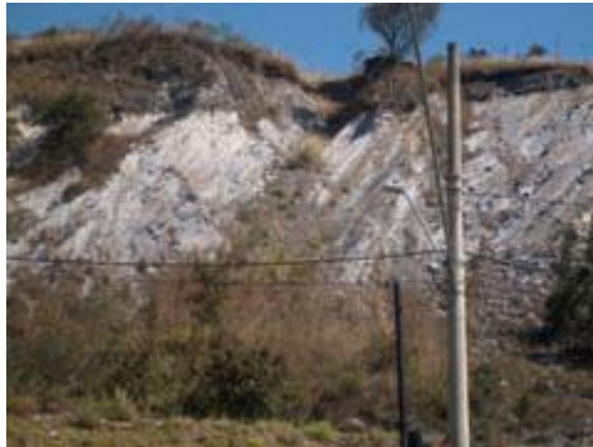
Figura 14- Escorregamento em cunha.
