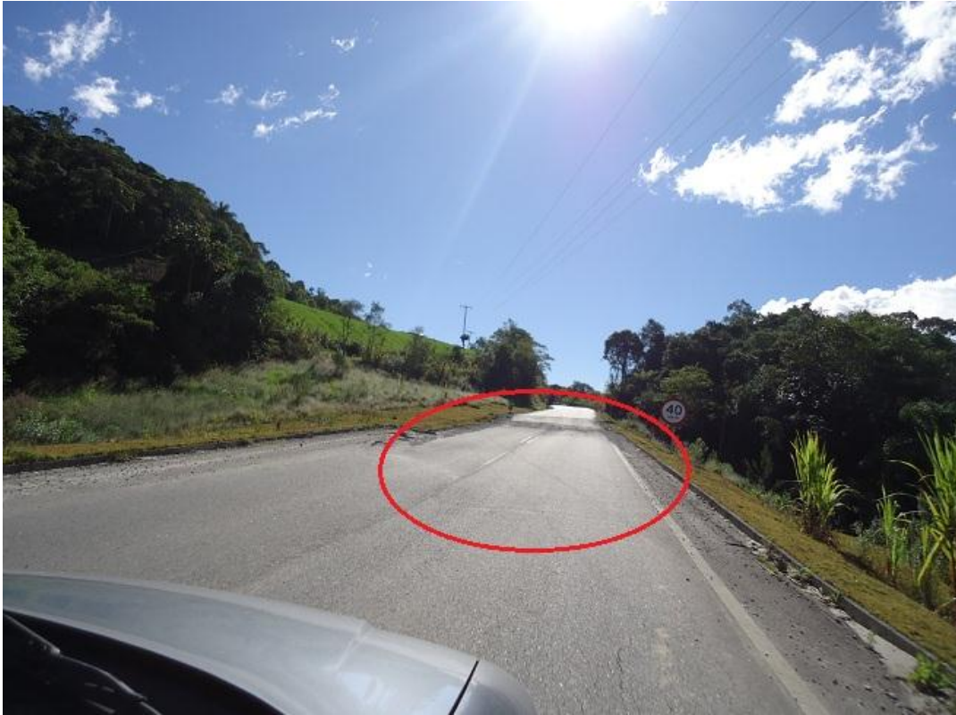
Rebaixamento da pista em decorrência de deslizamento de terra.
