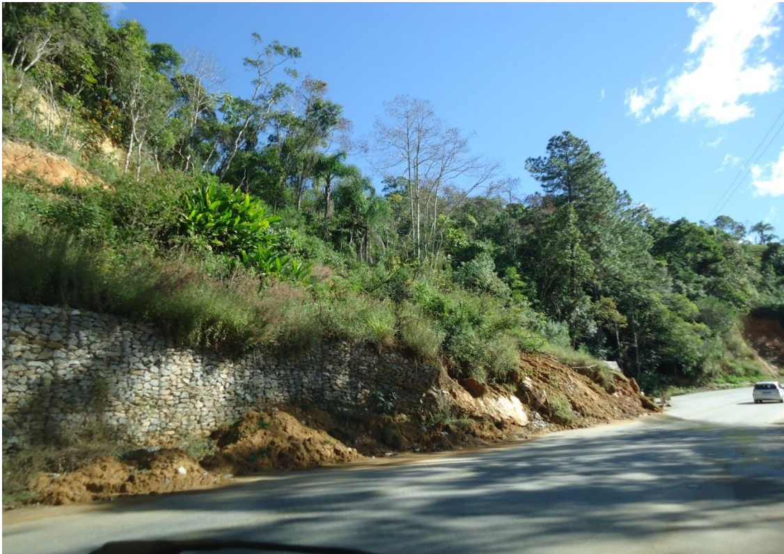
Deslizamentos de encostas prejudicando o trânsito.
