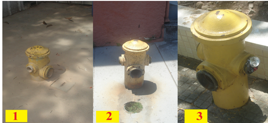
Figura 02: Hidrantes Urbanos soterrados (1), obstruídos pela vegetação (2), obstruídos por objetos (3), na Região Insular de Florianópolis
