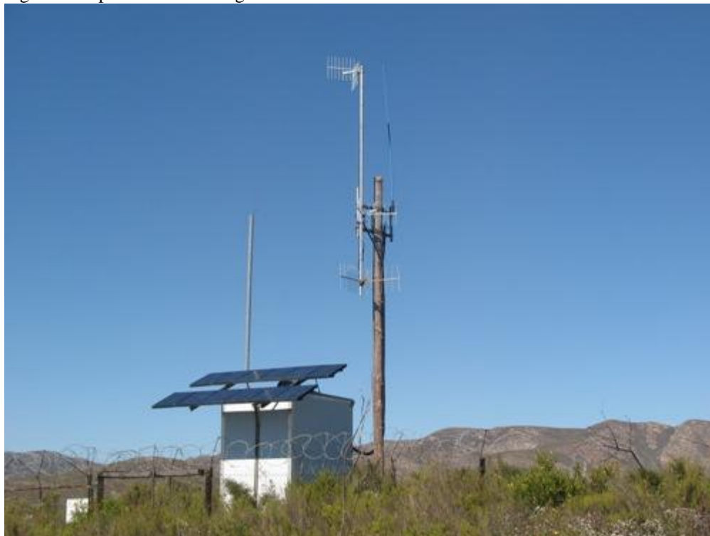
Figura 8. Repetidora com energia solar nas montanhas de Baviaanskloof na África do Sul.
