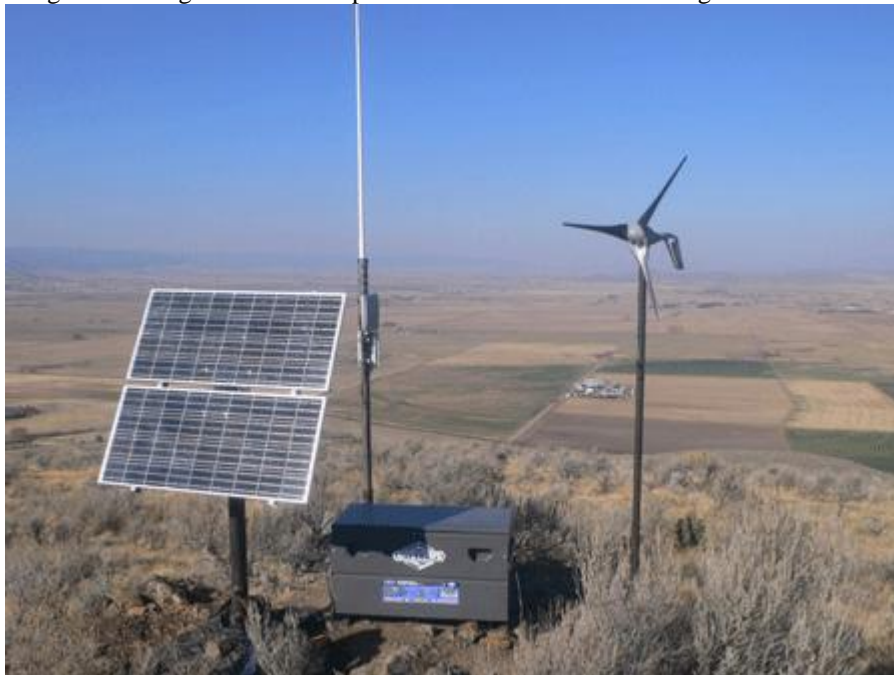
Figura 7: Fotografia de uma repetidora de rádio utilizando energia solar e eólica.
