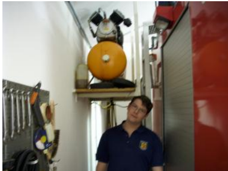
Figura 6 – Aparelho obstruindo a rota de passagem.
