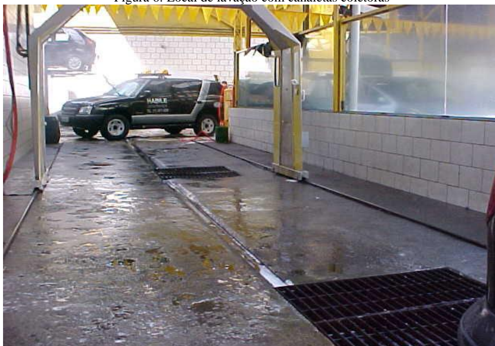
Figura 6: Local de lavação com canaletas coletoras
