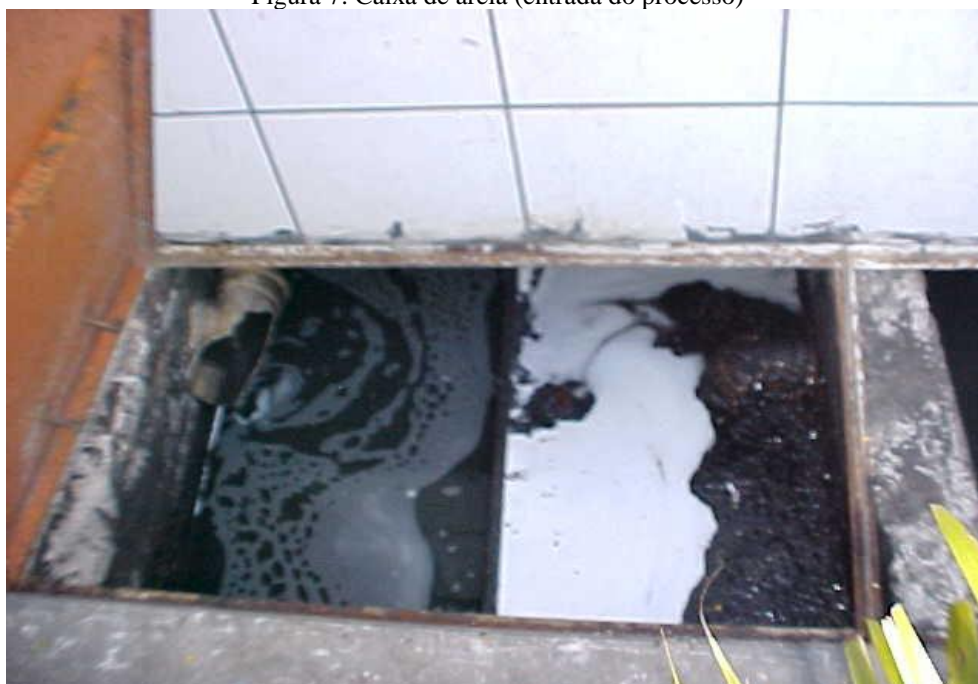
Figura 7: Caixa de areia (entrada do processo)
