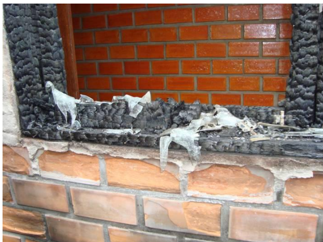
Foto 10: Vidro de janela que fundiu devido às elevadas temperaturas do incêndio Fonte: Do autor
