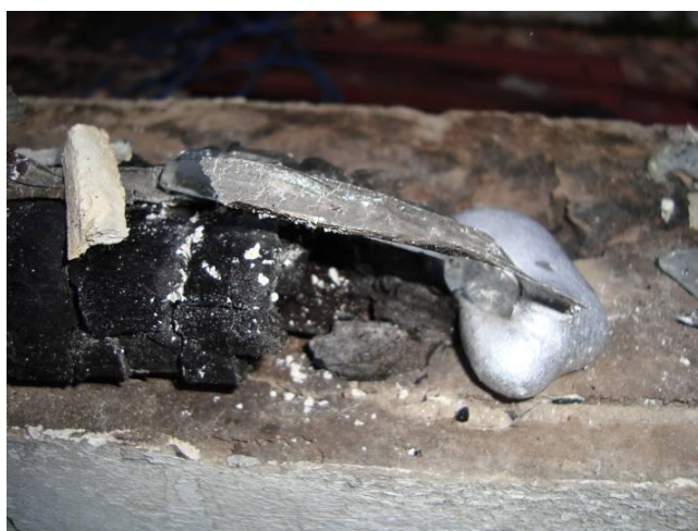
Foto 11: Alumínio que atingiu o ponto de fusão (648°C) devido à elevada temperatura que atingiu o incêndio Fonte: Do autor
