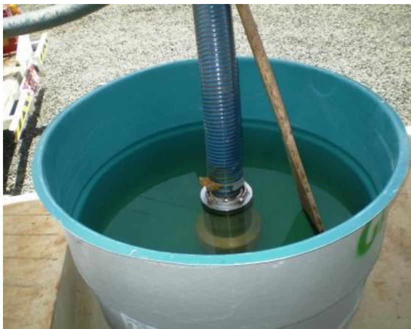
Foto 41: Válvula de retenção submersa e conectada ao mangote. Fonte: do autor.
