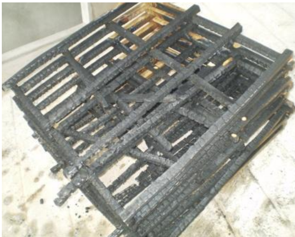
Foto 58: A intensa combustão reduziu a seção das ripas. Fonte: do autor.
