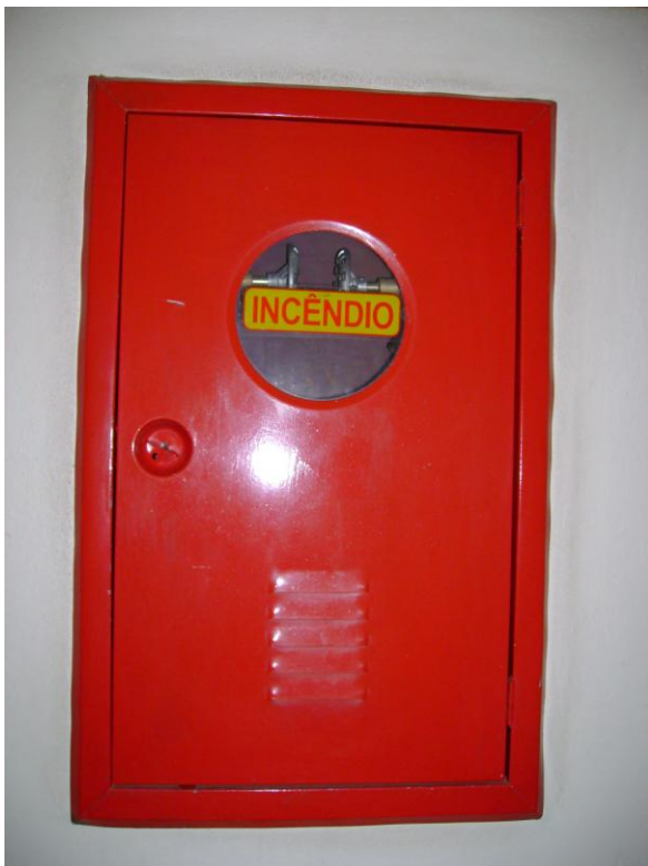
Foto 1 – Hidrante de parede - abrigo
