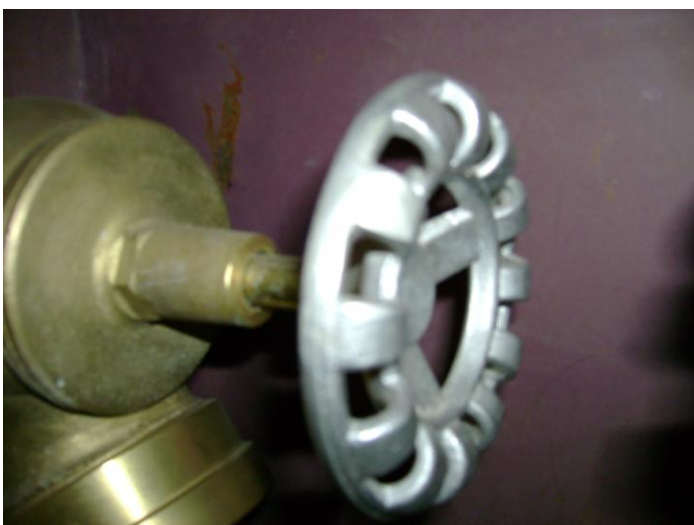
Foto 3 – Hidrante de parede – registro angular
