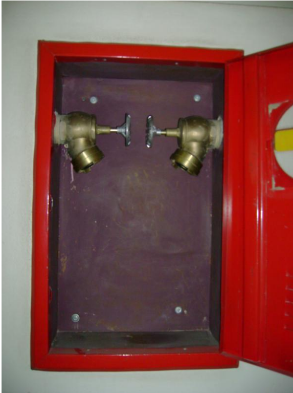
Foto 2 – Hidrante de parede – saída dupla
