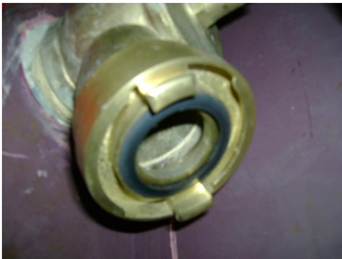
Foto 4 – Hidrante de parede – adaptador
