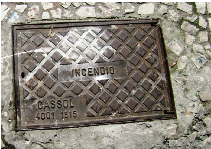
Foto 8 – Hidrante de recalque
