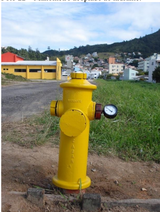
Foto 22 – Manômetro acoplado ao hidrante.
