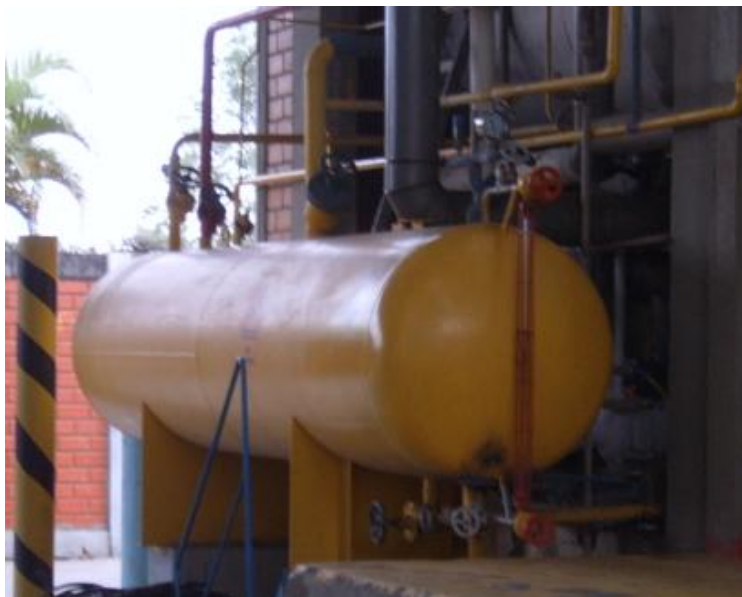
Foto 10 – Válvulas de controle de fluxo presentes no recipiente de líquido
