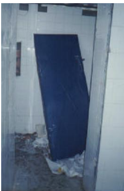
Abertura forçada de porta de aço para fuga
