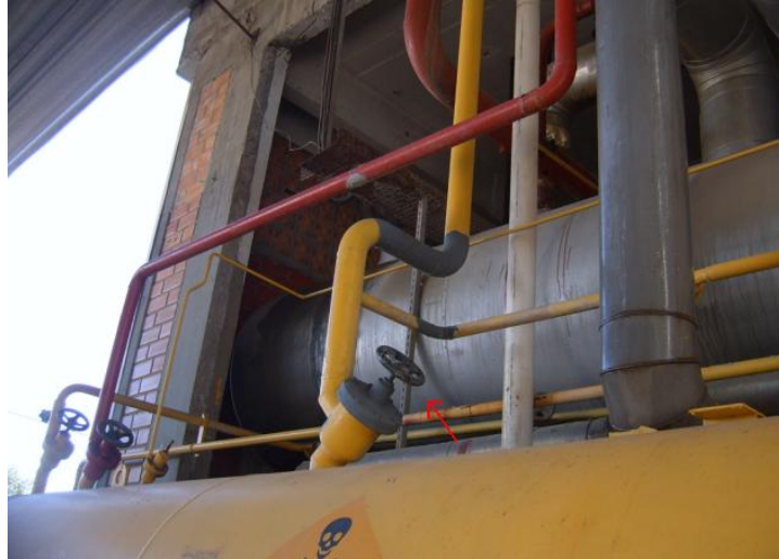
Foto 25 – Válvula a ser fechada no caso de um vazamento no recipiente de líquido
