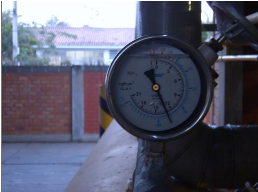
Foto 9 – Manômetro instalado no recipiente de líquido
