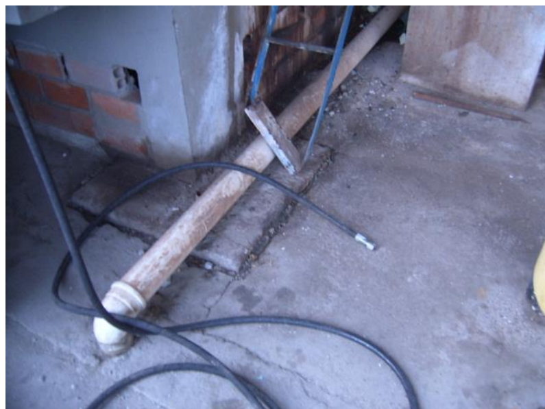
Foto 13 – Mangueira utilizada na reposição de amônia no sistema
