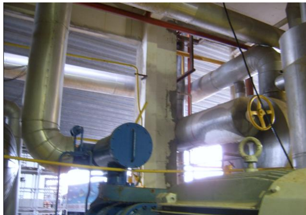
Foto 20 – Tubulação que liga o compressor à torre de resfriamento
