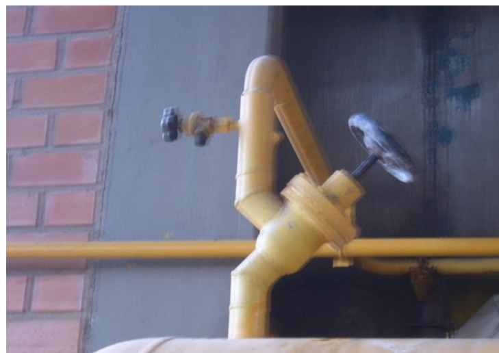
Foto 26 – Válvula a ser fechada no caso de um vazamento no separador de líquido
