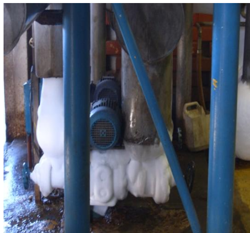
Foto 22 – Bombas que impulsionam a amônia líquida até os evaporadores
