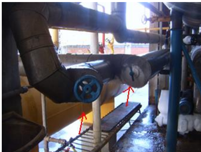
Foto 32 – Válvulas de saída da bomba
