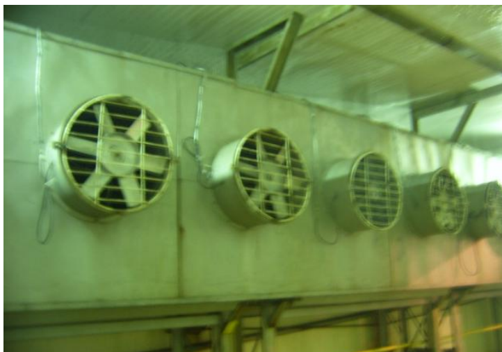
Foto 24 – Evaporador (instalado no interior da câmara frigorífica)
