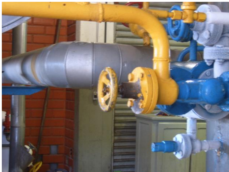
Foto 27 – Válvula a ser fechada no caso de um vazamento no separador de líquido
