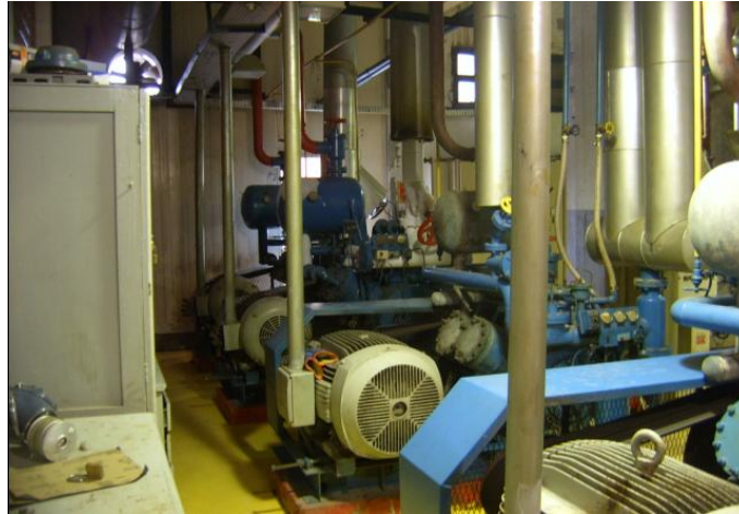
Foto 17 – Compressores de baixa (últimos dois ao fundo da sala de máquinas)
