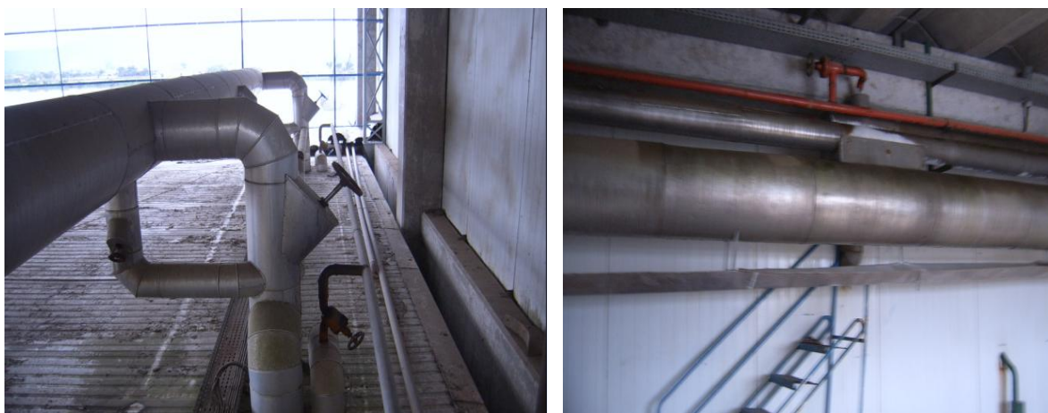
Foto 23 – Tubulações que conduzem a amônia líquida até os evaporadores
