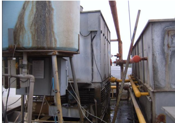
Foto 21 – Torre de resfriamento
