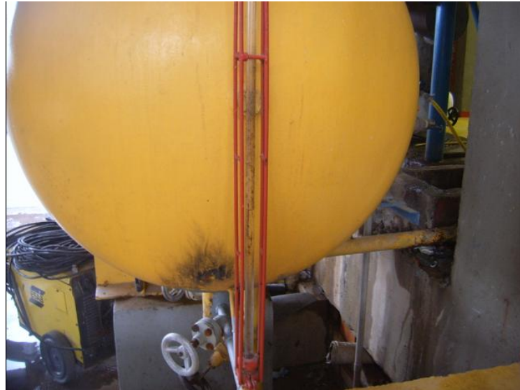
Foto 12 – Medidor do nível de amônia
