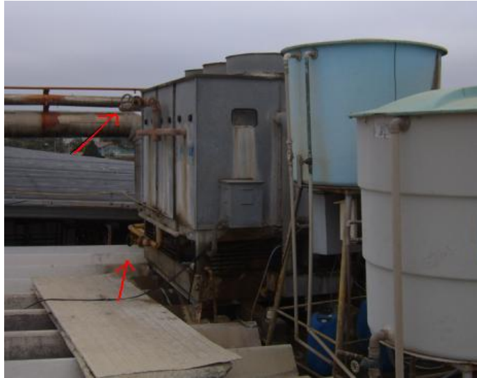
Foto 30 – Condensador com destaque para as válvulas de entrada e de saída Fonte: Do autor
