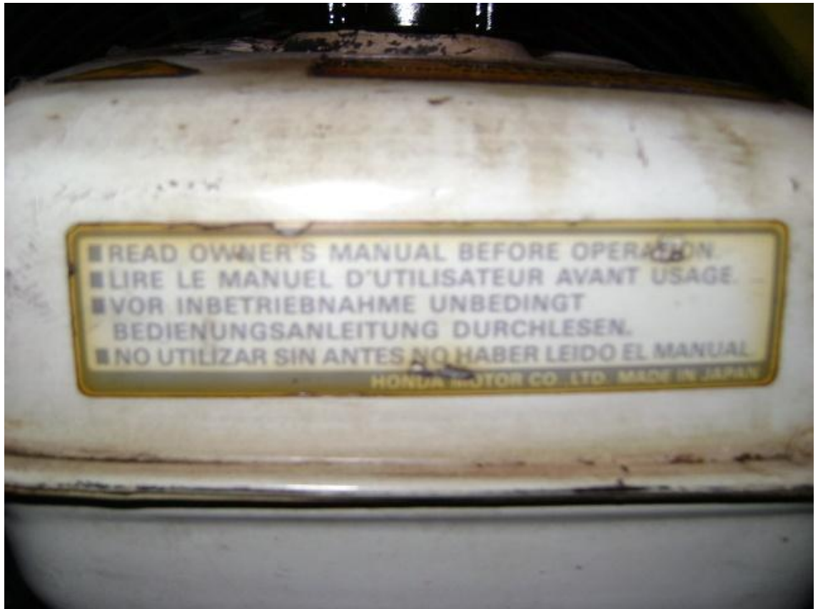
Foto 6: Rótulo de segurança do motor do aparelho de ventilação/exaustão.
