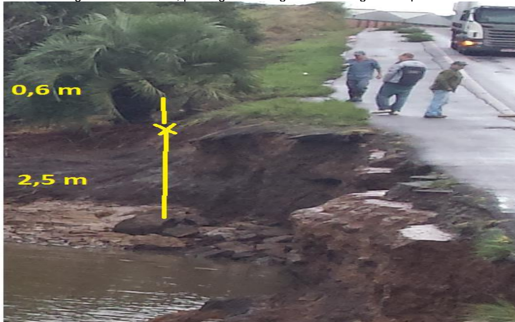
Figura 28 – BR 282, passagem das águas da barragem rompida
