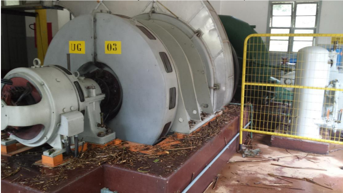
Figura 29 – Casa de Força da PCH São Luiz invadida por detritos
